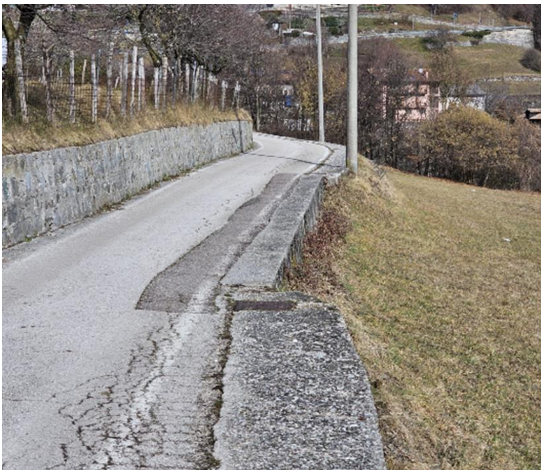
Strettoia PERICOLOSA con semicurva cieca, e senza protezione.
